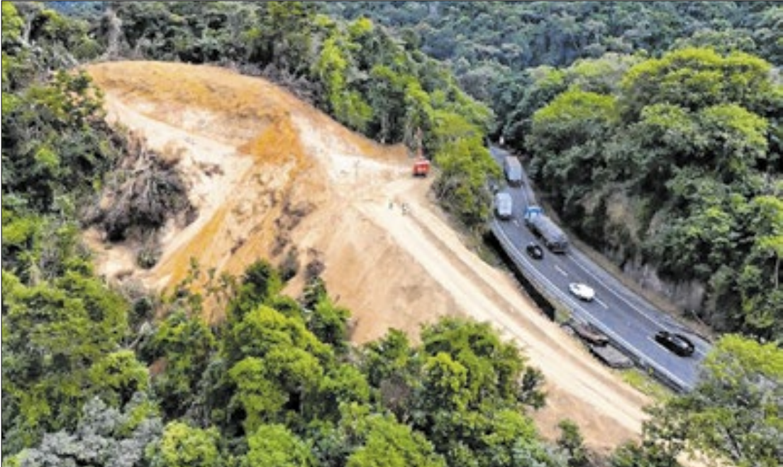
Desmontes de rochas ocorrem periodicamente na altura de Paracambi
