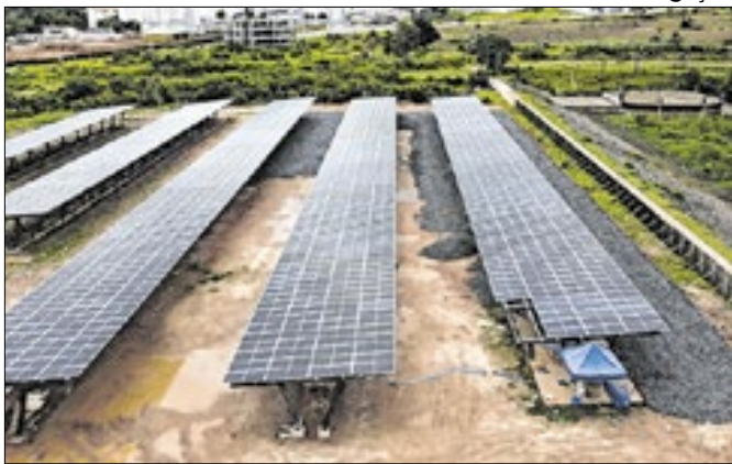
Usinas solares fotovoltaicas em Hortolândia
