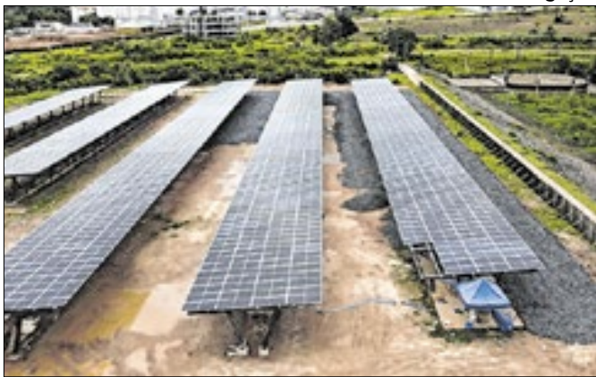
Usinas solares fotovoltaicas em Hortolândia
