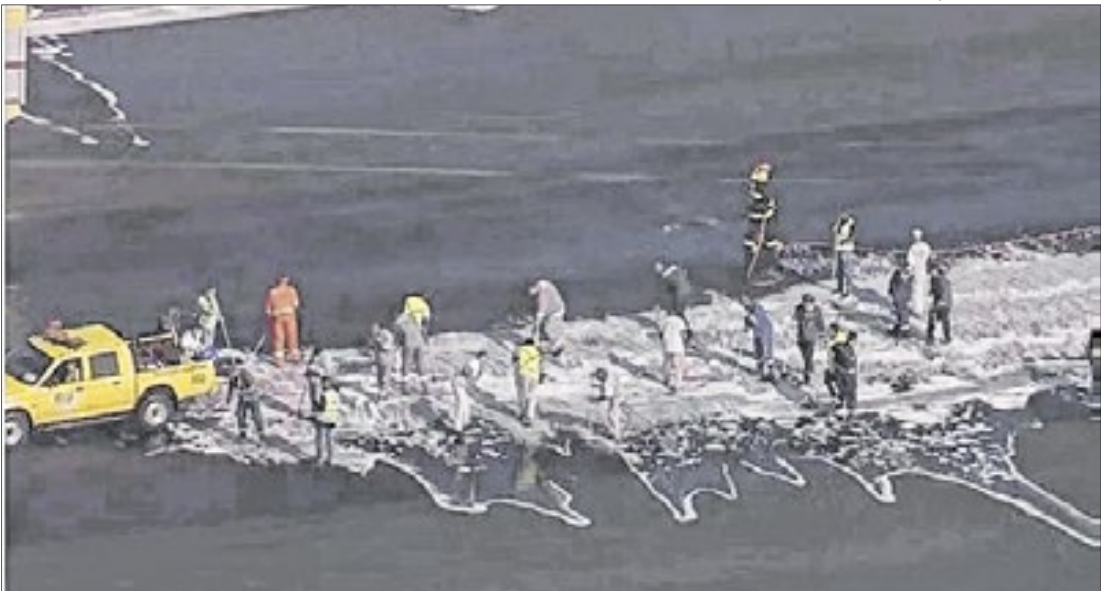
Funcionários do Santos Dumont trabalhando para remover o óleo da pista
