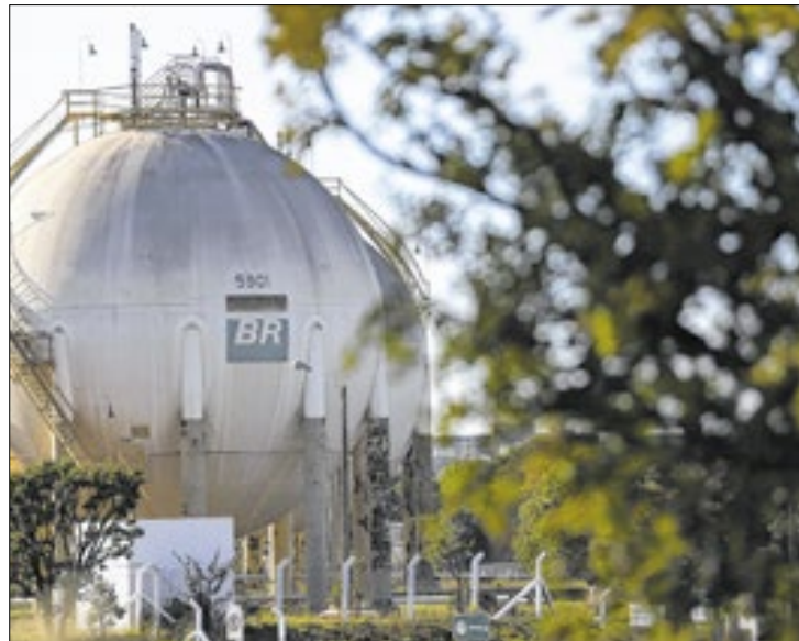
Reservatórios de combustíveis da Transpetro, em Brasília
