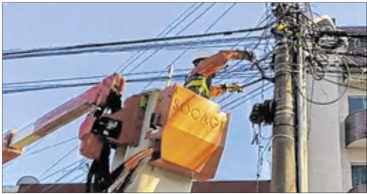
Quase três anos depois, a Justiça modificou o seu entendimento e voltou a autorizar a Neoenergia a cortar os cabos irregulares dos postes
