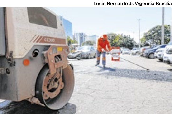
O ‘GDF nas Ruas’ passará por 10 das 35 RAs, onde foram identificados altos níveis de deterioração no pavimento
