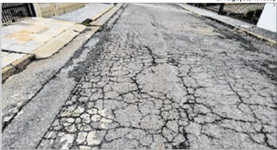
Asfalto craquelado e esfarelado, como este em Taguatinga, indica que está oxidado e com vida útil vencida
