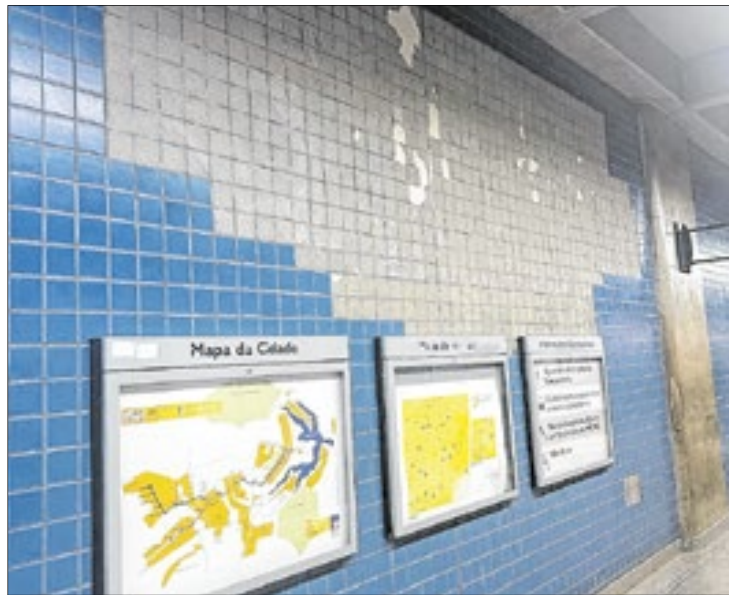
Parede descascada no Terminal Central, o de mais movimento do Metrô-DF
