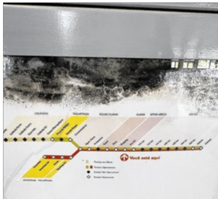
Detalhe de um dos painéis "de orientação" do Terminal Asa Sul, mofado e desatualizado
