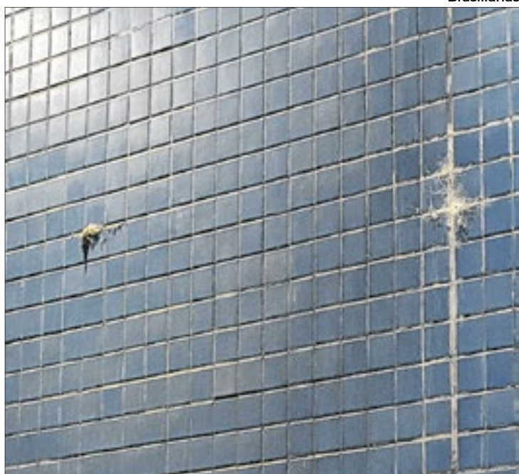
Parede da estação do Terminal Central com resíduos semelhantes a fezes de aves, grudadas na parede
