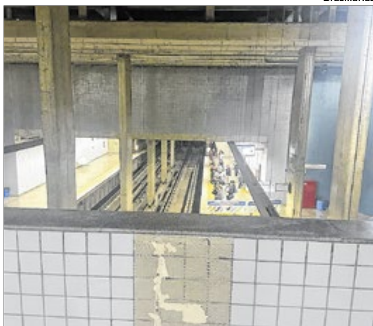
Pastilhas caídas, bem na entrada da Estação Central
