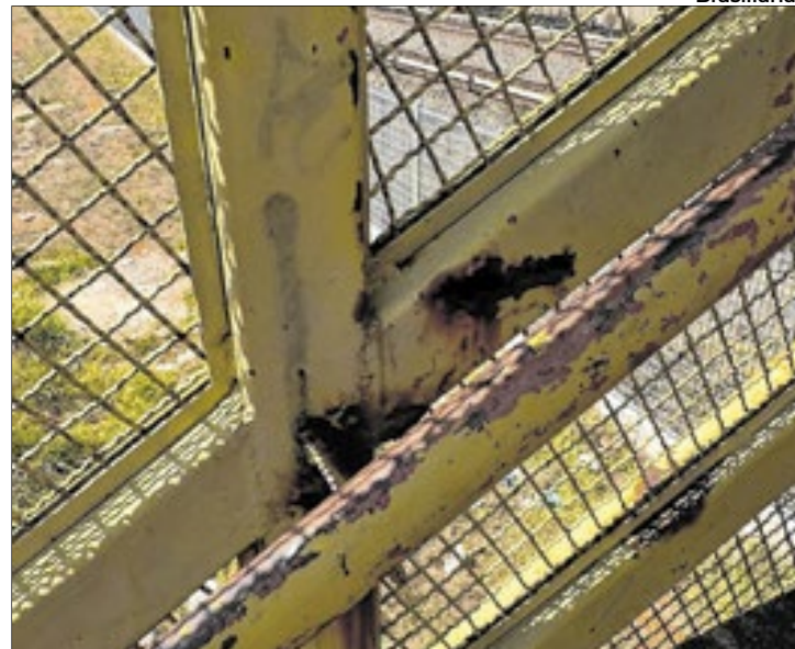
Na estrutura metálica, há furos nas vigas de sustentação, causados pela ferrugem
