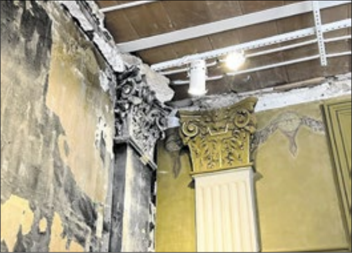
Contraste entre as paredes reformadas e as queimadas
