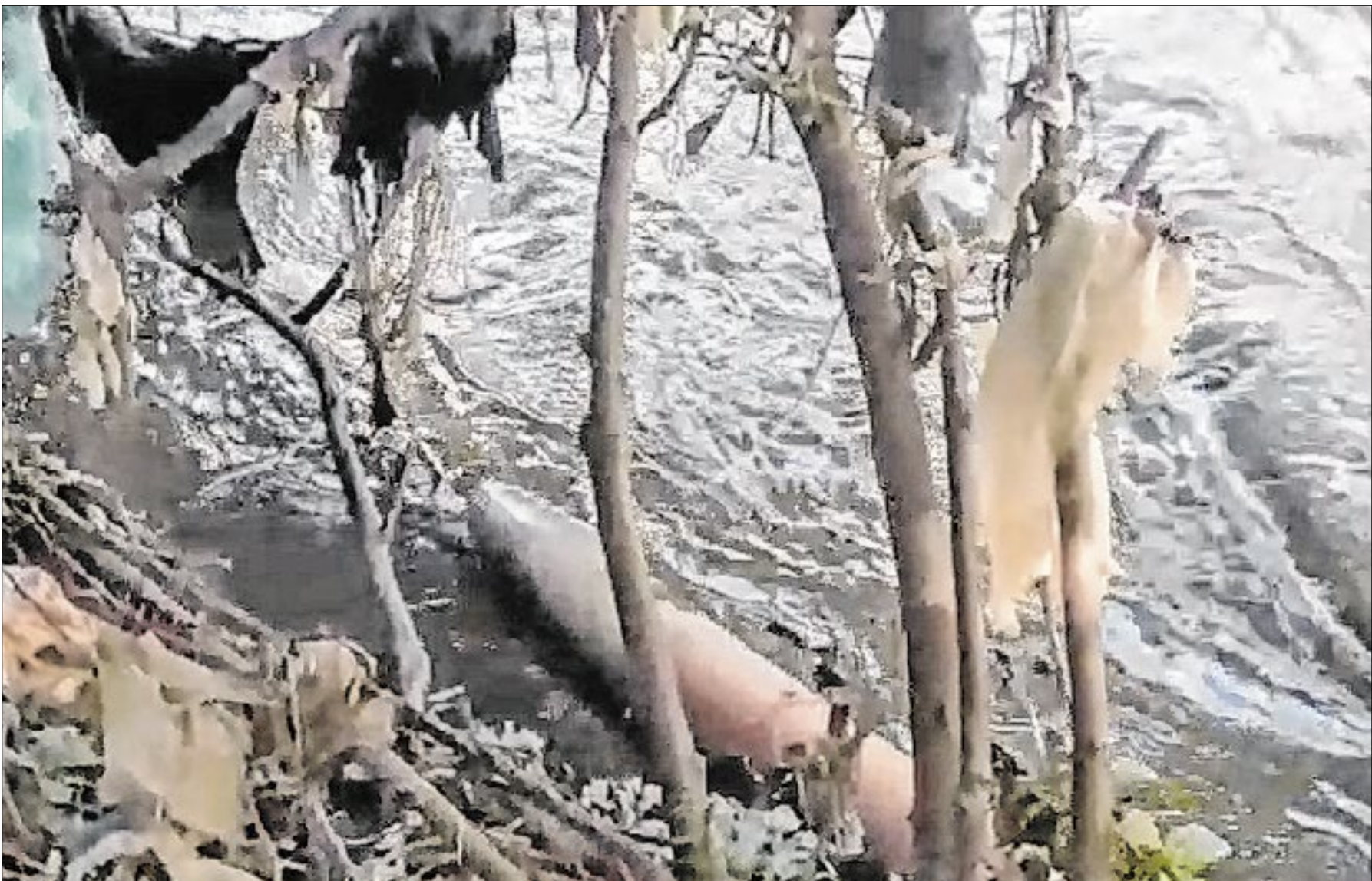
Cano do aterro sanitário que despeja chorume no rio. Água é consumida por comunidades
