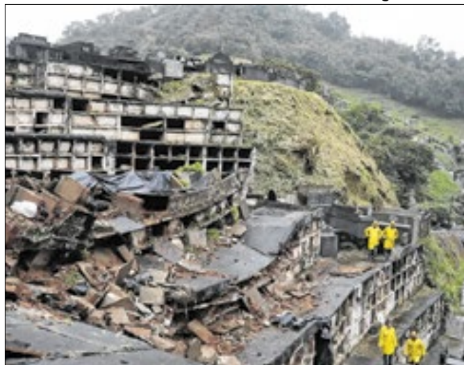
Estrutura colapsou com as chuvas de março de 2023
