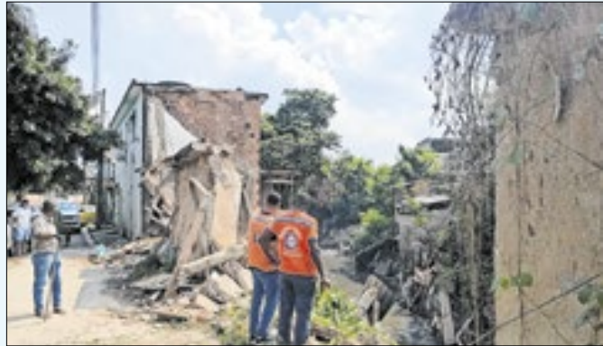
Defesa Civil fez a vistoria às margens do Rio Botas
