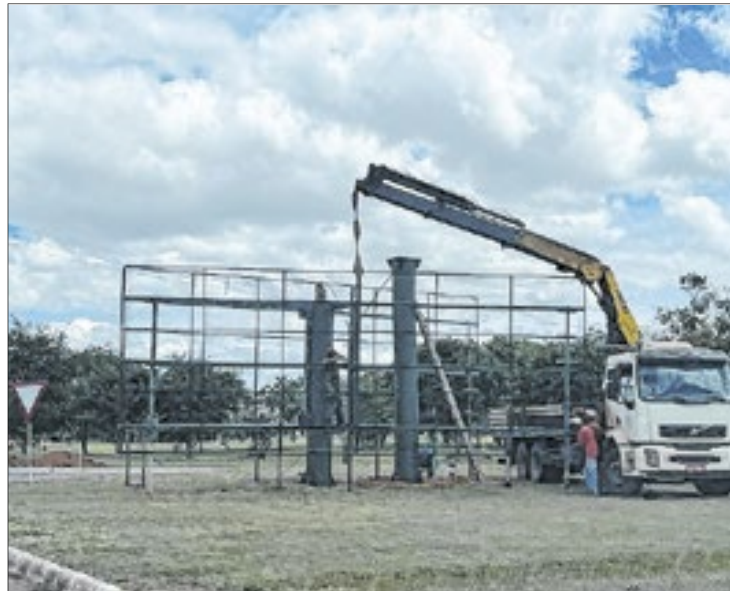
O caminhão começou a instalar os painéis na manhã de domingo, no Park Way
