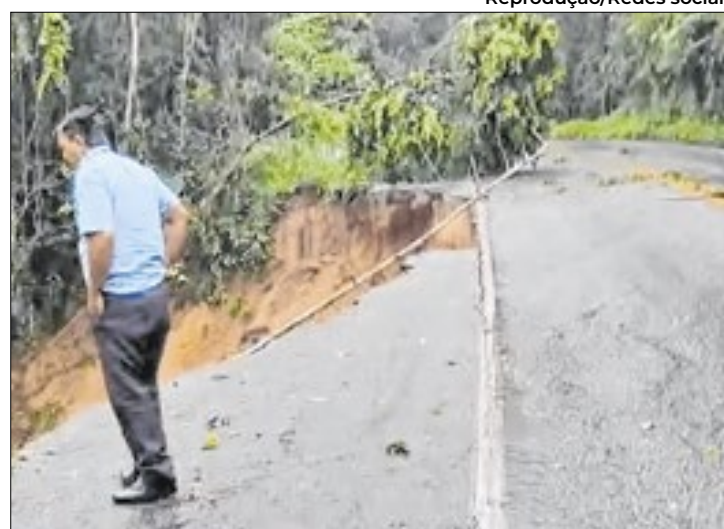
Pista sentido Angra da RJ-155 cedeu na altura de Rio Claro
