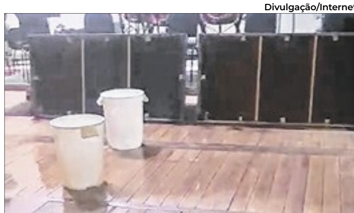
Vídeo mostrou o vazamento de água no palco na Martins Pena e percorreu o DF, ontem
