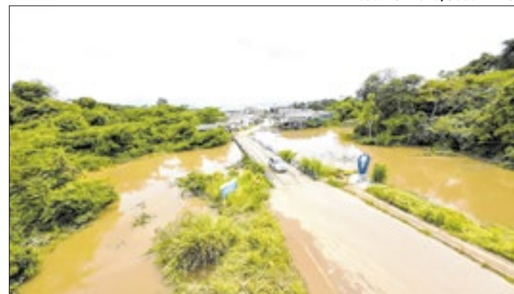
Estrutura atual da ponte é afetada durante enchentes
