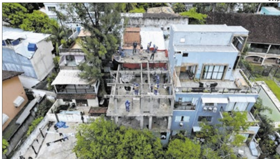
Agentes da Seop concluem demolição de imóvel irregular na Ilha da Gigóia
