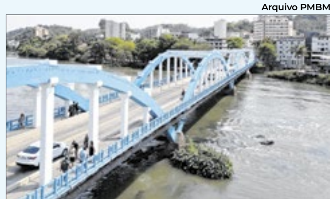
Fiação furtafadas afetaram toda a parte elétrica
