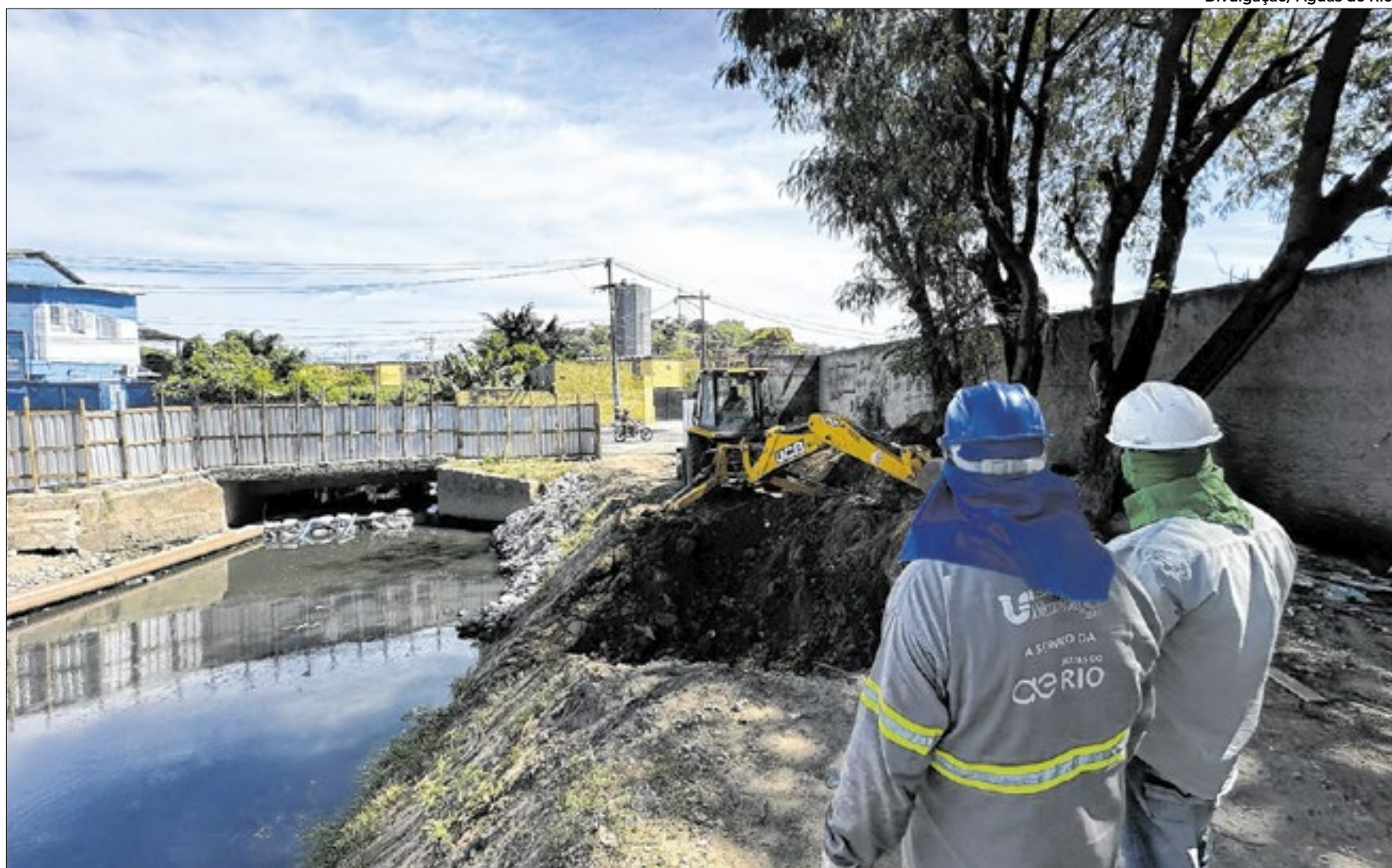
As obras do sistema Coleta em Tempo Seco seguirão avançando pelos municípios que margeiam a baía
