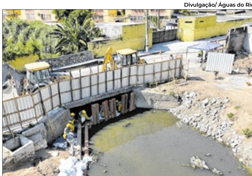
A captação de esgoto será feita nos rios Imboassú, Brandoas e Bomba, além de uma galeria pluvial na Rua Cônego Goulart
