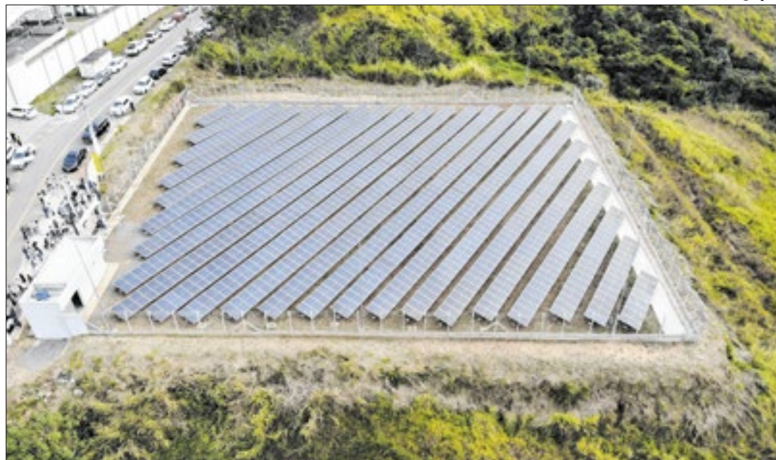
Usina Fotovoltaica Miguel Archanjo da Rosa fica no bairro Roma, em Volta Redonda
