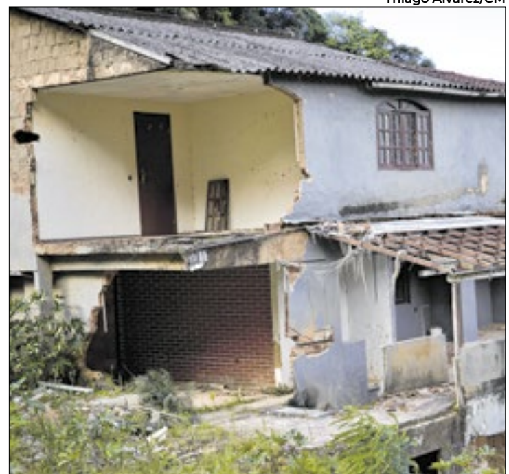
Situação de uma casa afetada pelas chuvas no Vila Felipe
