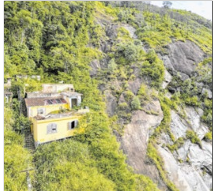
Diversas casas foram interditadas no bairro Caxambu
