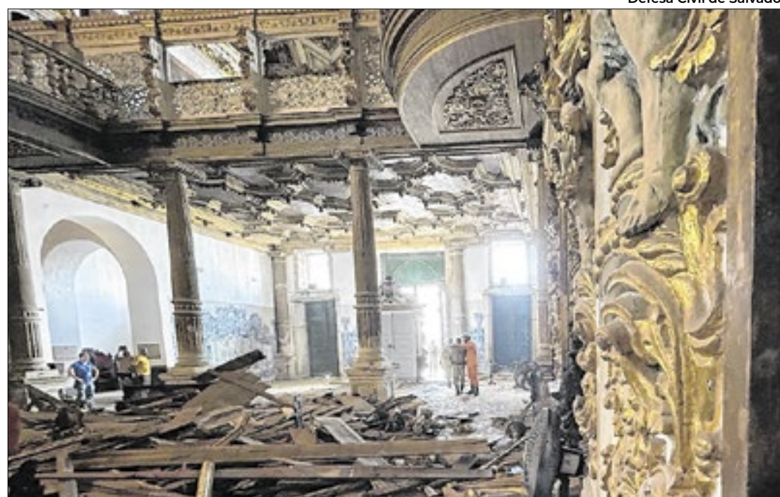
Teto da igreja de ouro desabou em Salvador na terça-feira (5)
