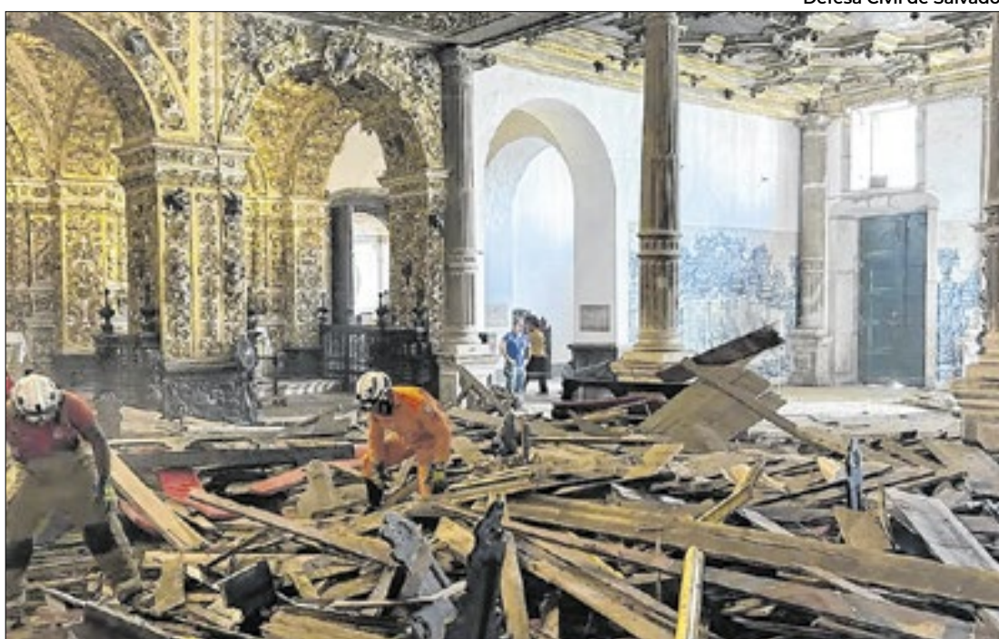
Teto da Igreja de São Francisco desaba em Salvador
