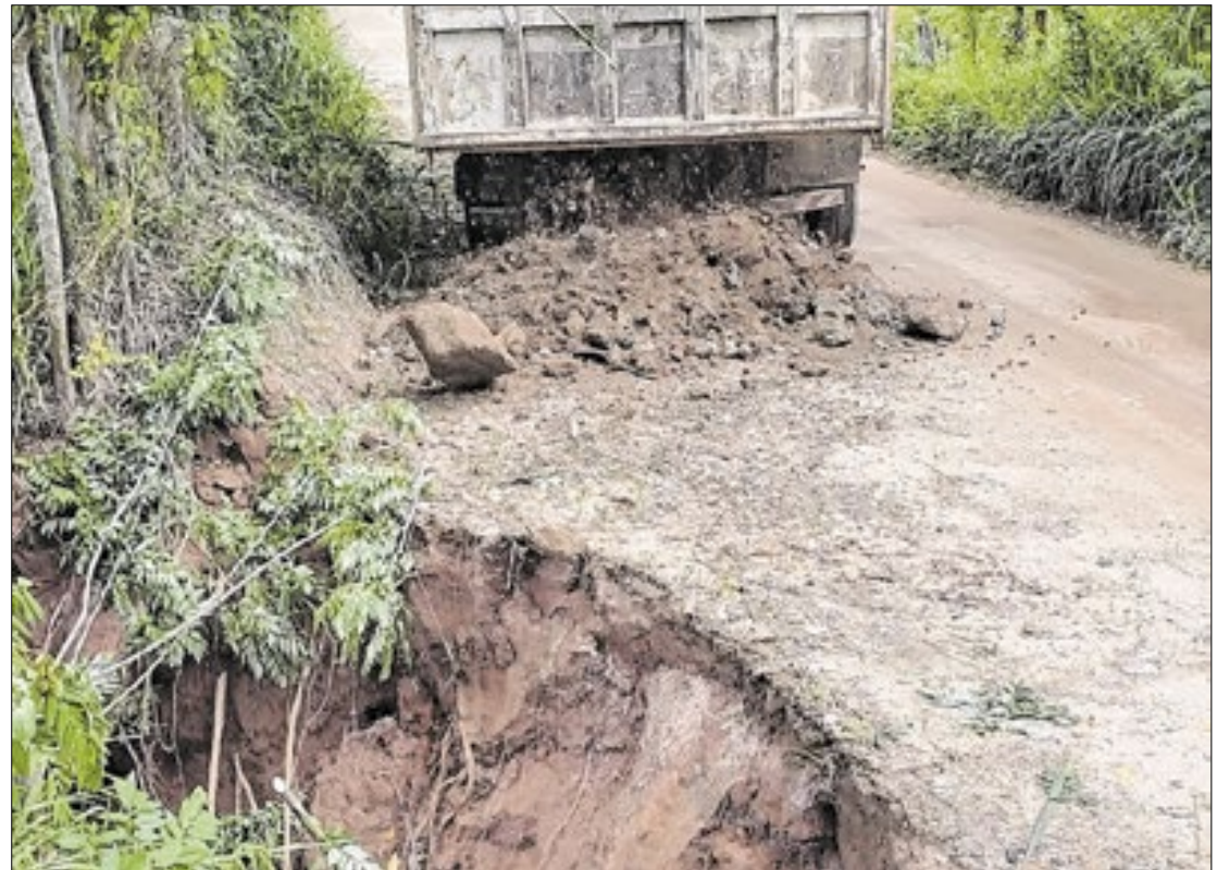
Erosão causada pelas chuvas na estrada que liga Cordeiro ao distrito de Monnerat
