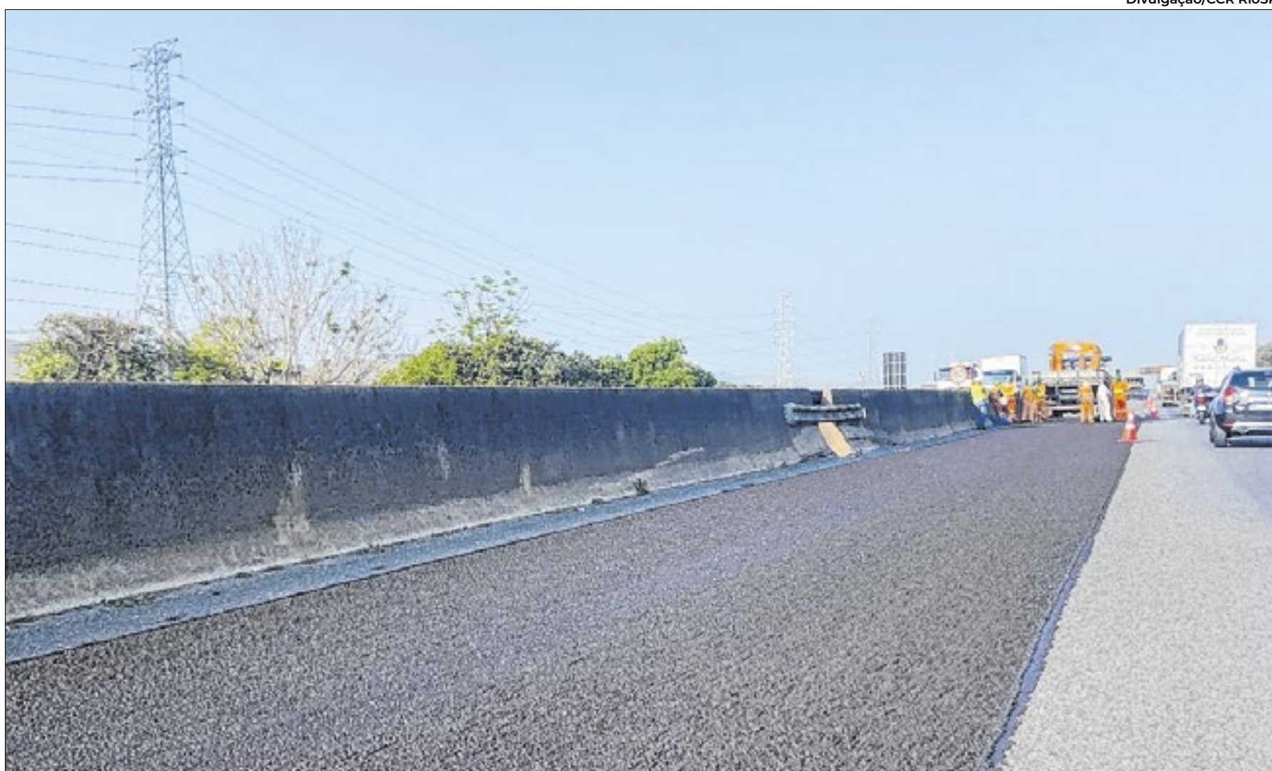
Projeto piloto da CCR RioSP com uso de produto siderúrgico é testado na Via Dutra na altura de Resende, na região das Agulhas Negras
