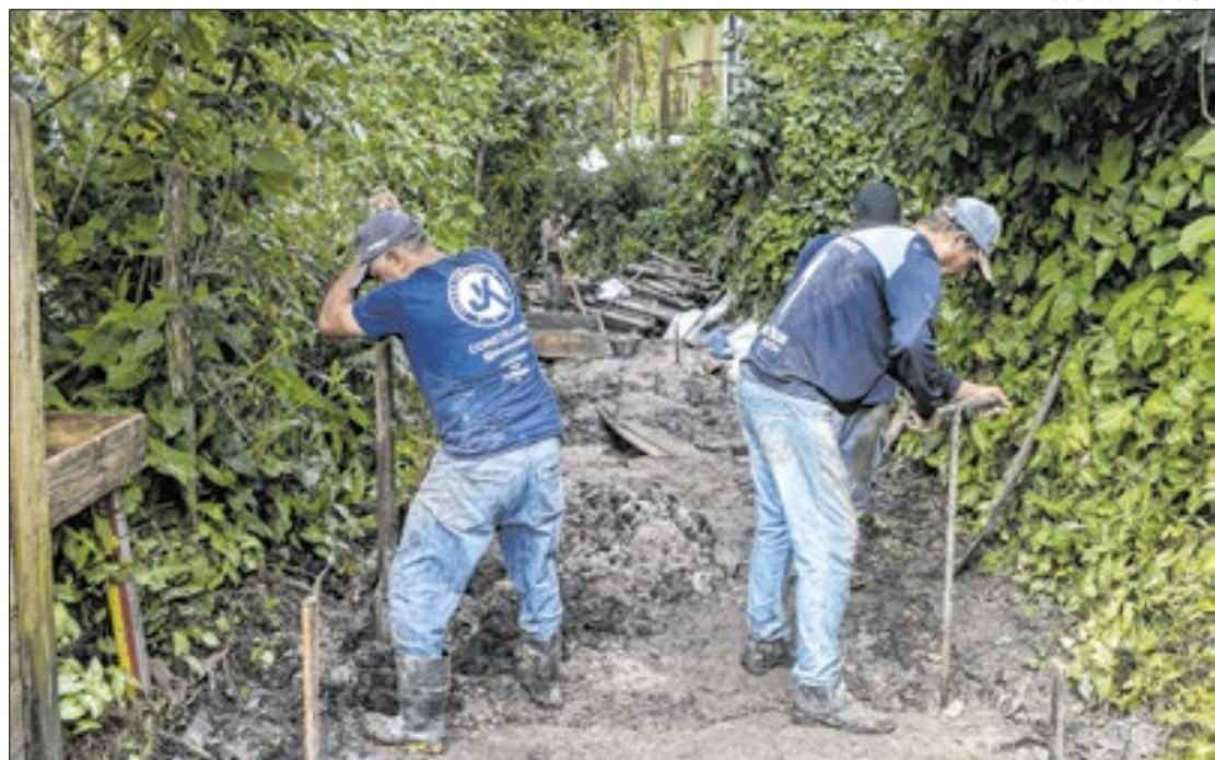
As obras, que iniciaram em maio de 2024, têm prazo de conclusão de 12 meses
