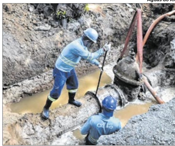
Rompimento da adutora precipitou a ação judicial
