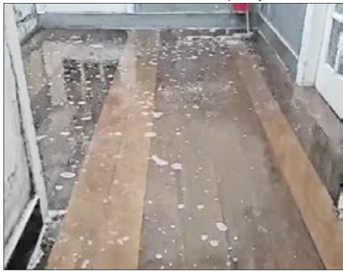
Vídeos mostram salas da CMP repletas de água
