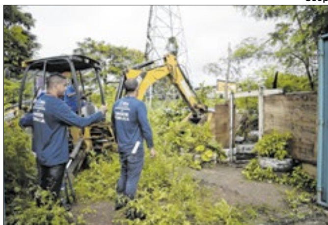
Construções estavam próximas de linhas de transmissão
