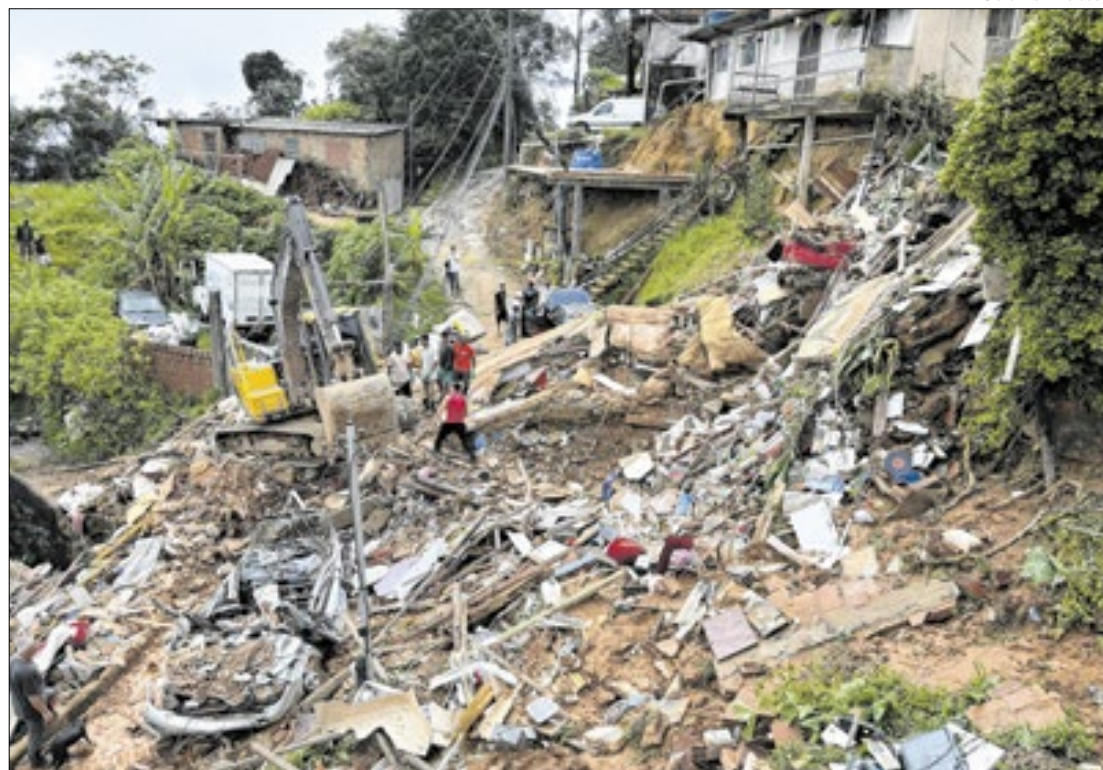
Deslizamento de março deste ano no bairro Independência matou cinco pessoas
