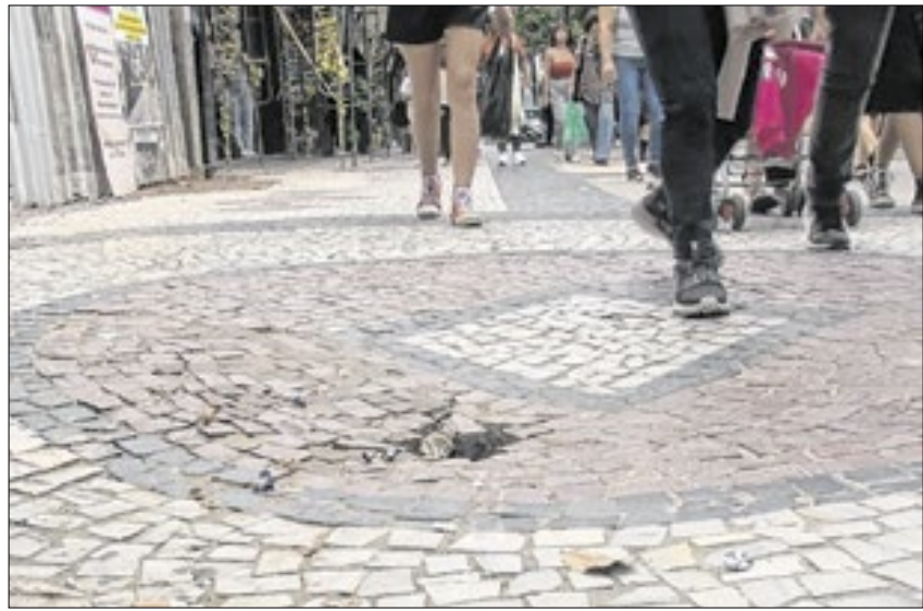
Moradores chegaram a colocar uma caixa de madeira para alertar
