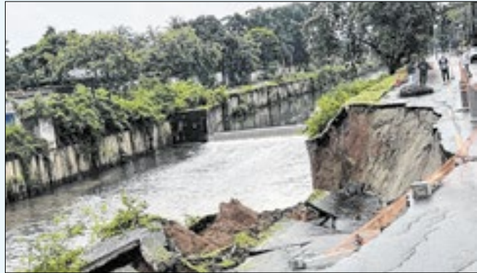
Excesso de chuvas causou desmoronamento de contenção
