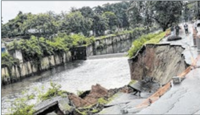
Excesso de chuvas causou desmoronamento de contenção
