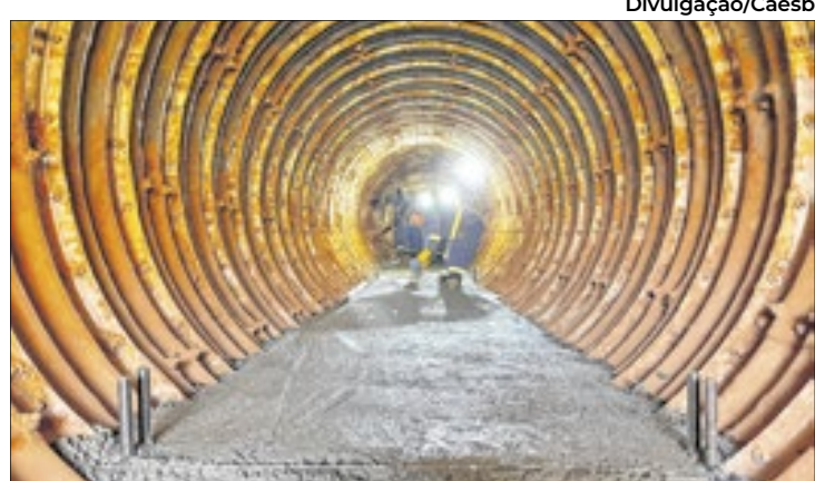
A rede vai captar água da Estação de Tratamento de Água (ETA) Corumbá, em Goiás
