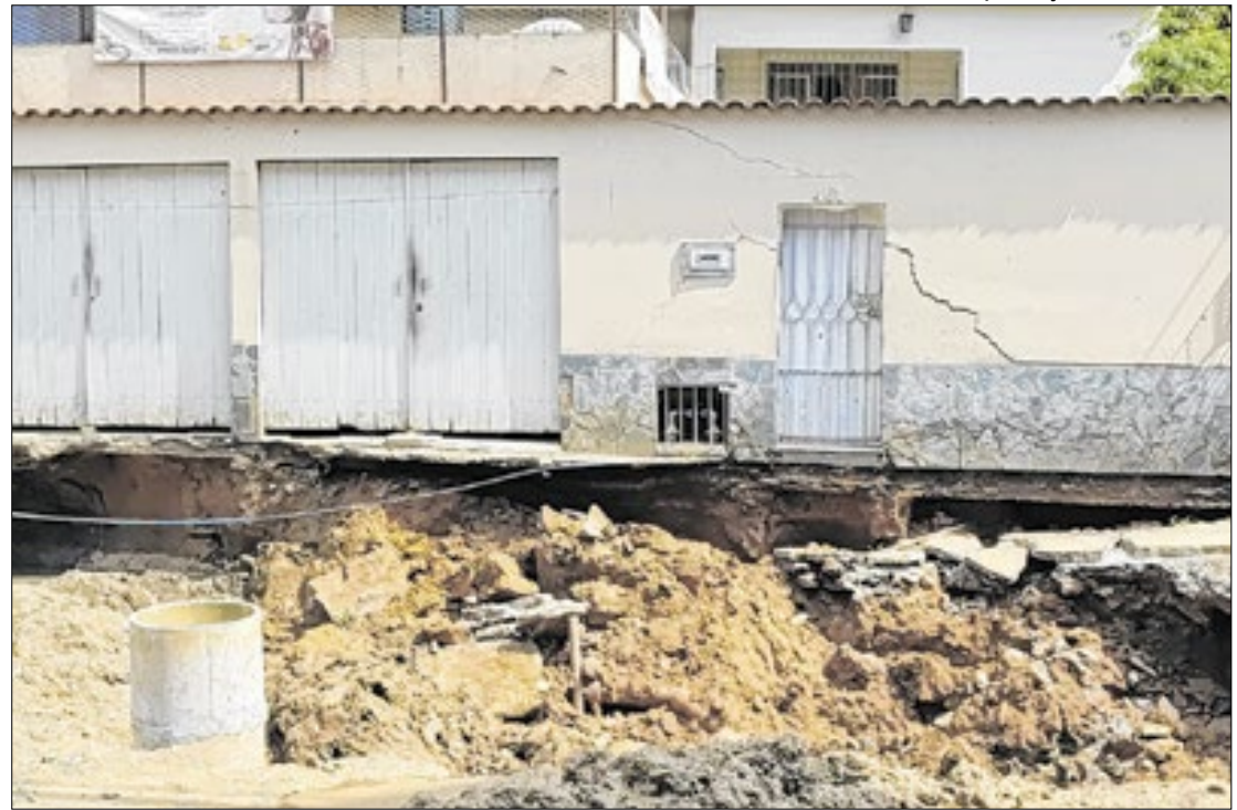
Fotos registraram uma casa que ficou sem calçada devido a obra há duas semanas
