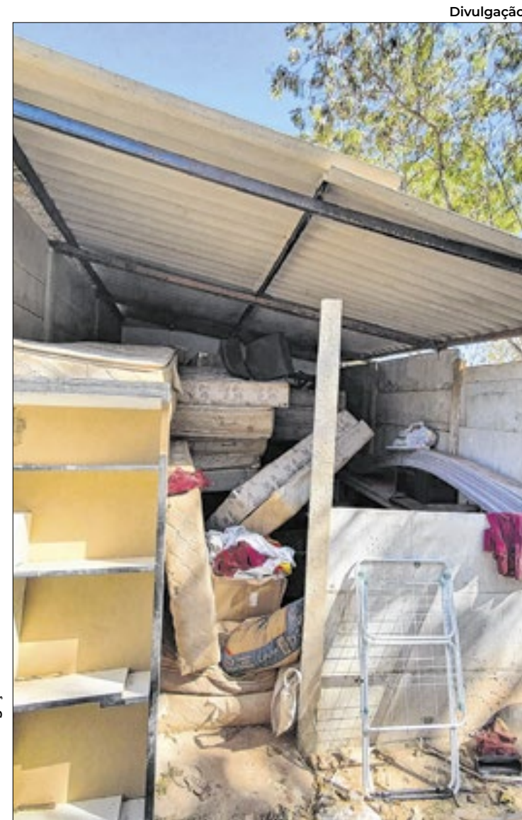
Antes da obras, só havia lixo e entulho
