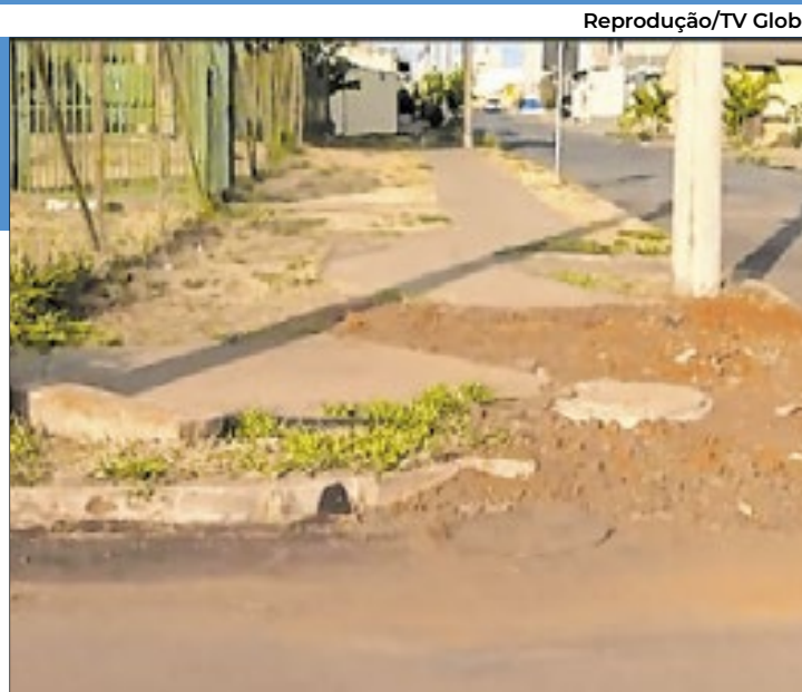
Calçada recém feita, numa esquina do Riacho Fundo II, que foi destruída por obra de reparo da Caesb
