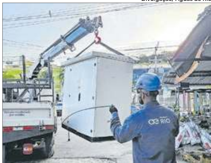
Equipamentos aumentam a pressão no sistema
