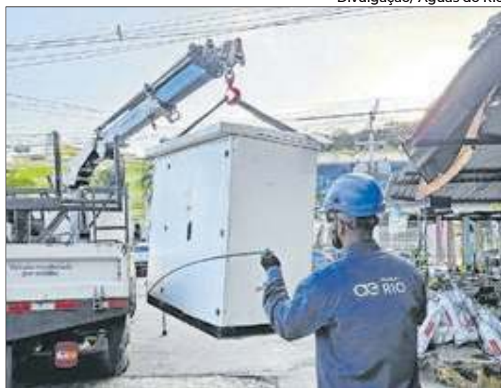
Equipamentos aumentam a pressão no sistema
