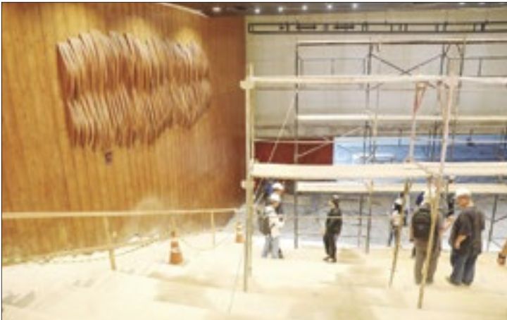
Painel acústico de Athos Bulcão, instalado no interior da Martins Pena, está preservado.
