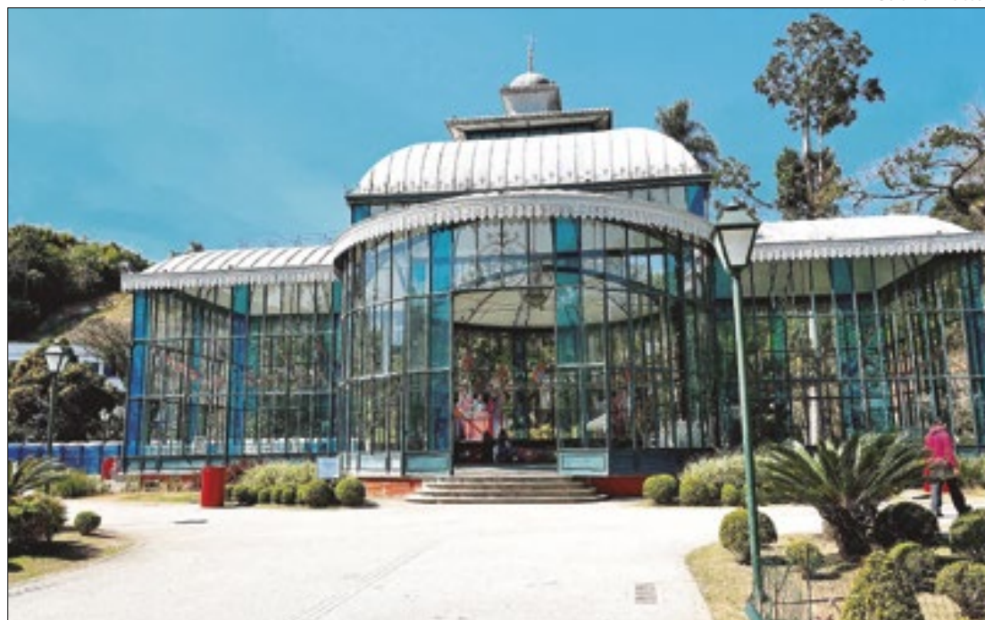
Chuvas de 2022 e 2023 prejudicaram o telhado, que está com goteiras e ranhuras
