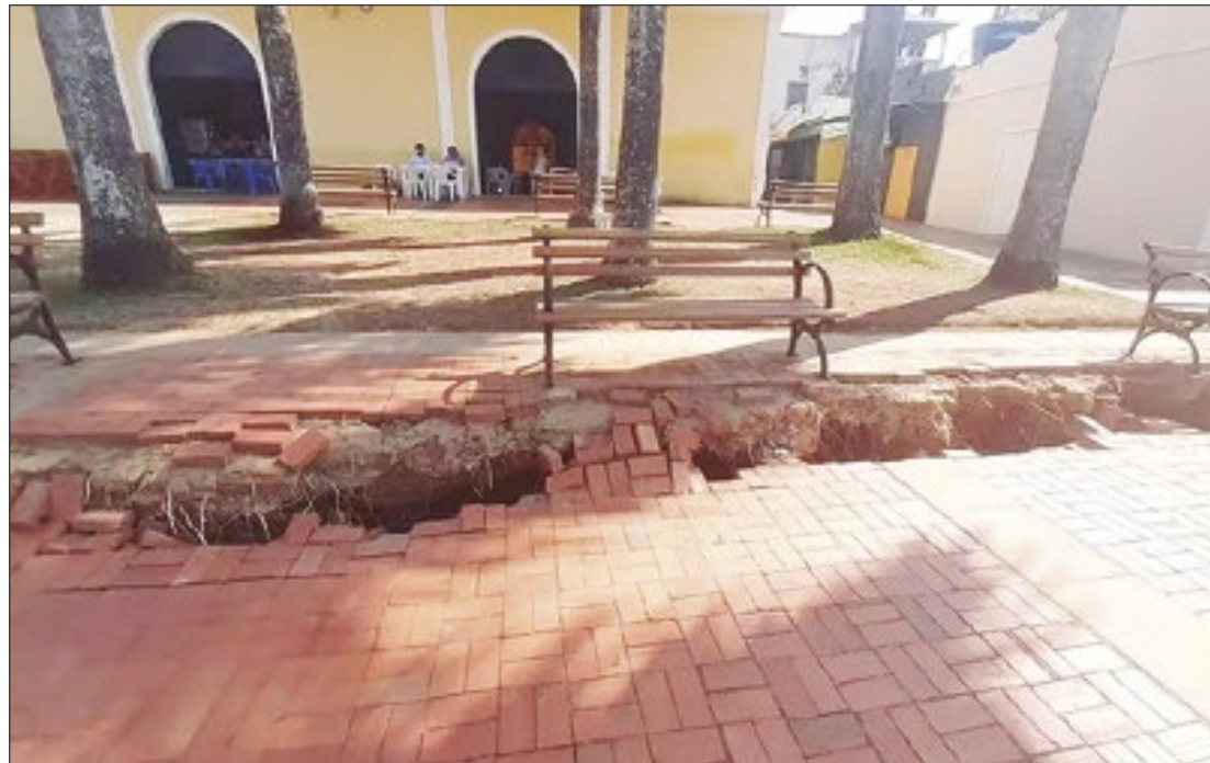
Calçadão do Novo Mercado Velho apresenta rachaduras e erosões
