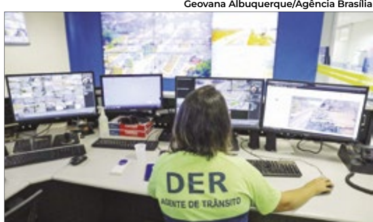
Numa central do DER-DF os semáforos inteligentes são controlados, à distância
