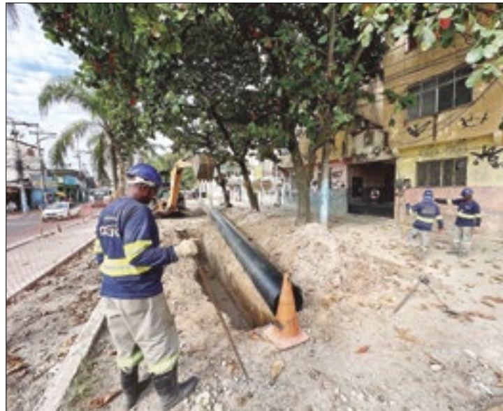
7 milhões de litros de esgoto por dia serão tratados
