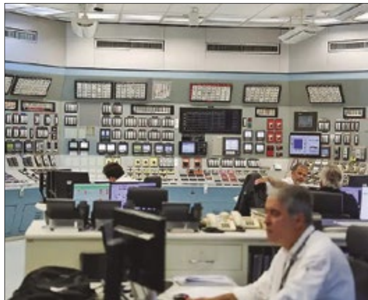
Monitoramento na Central Almirante Álvaro Alberto
