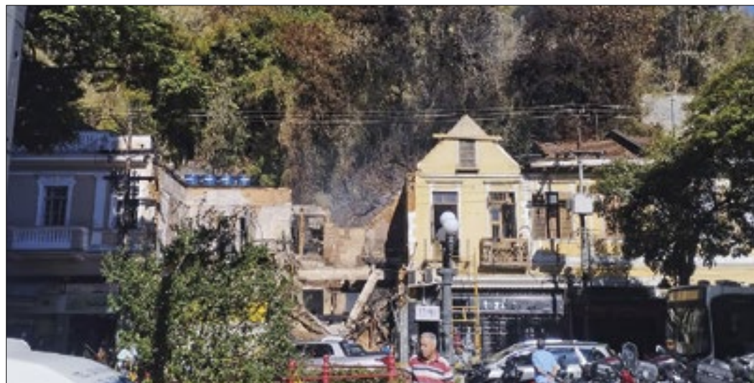
Trecho da calçada ainda está interditado e há cheiro de fumaça nos arredores
