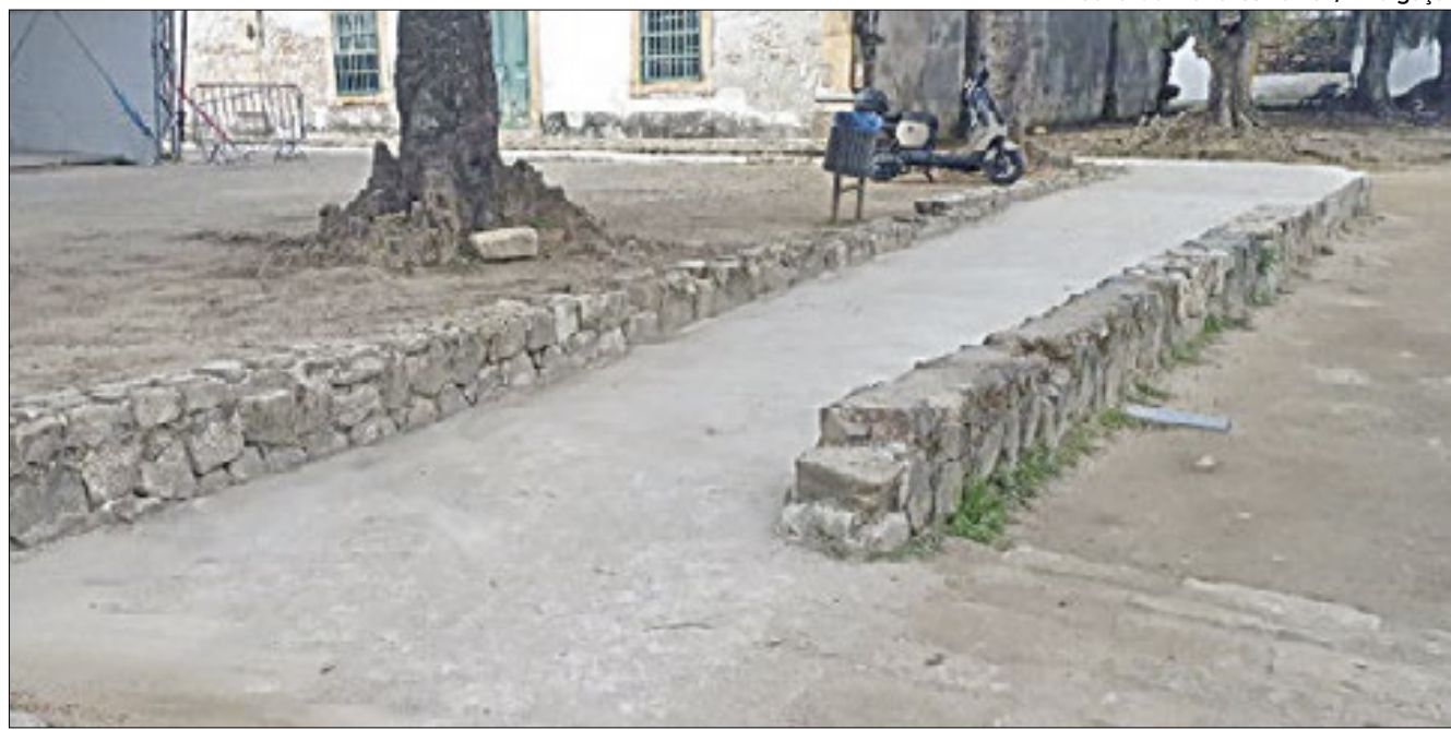
Calçamento das ruas históricas de Paraty com pedras irregulares dificulta circulação de moradores e turistas
