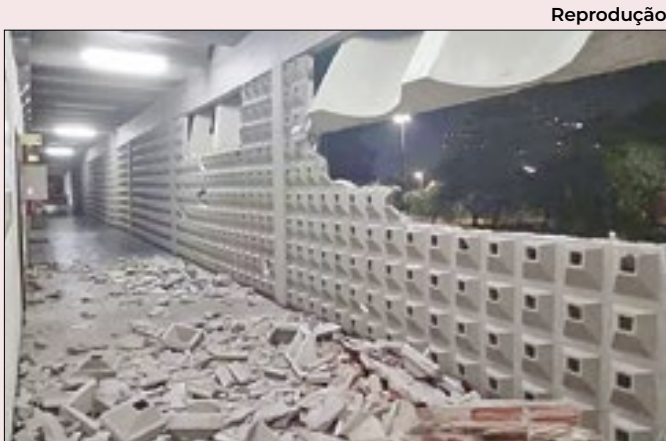
Pedaco de muro desabou na Educação Física
