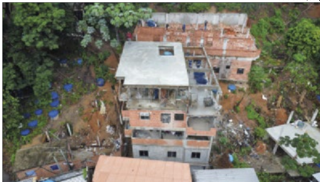
As construções estavam sendo erguidas sem qualquer licença em área de encosta
