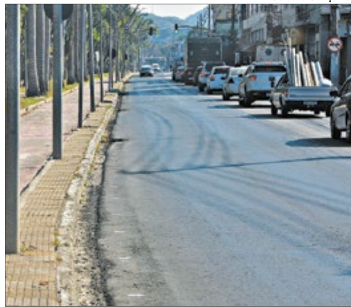
Estrutura da ciclovia da Beira Rio é alvo de reclamações
